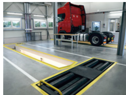
V sklopu delavnice sta tudi dva servisna kanala in testni valjčki.
